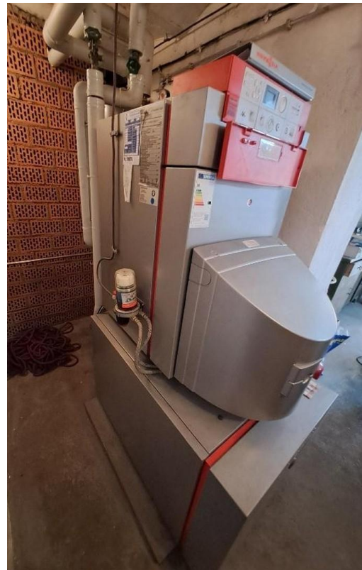
Zentralheizung im Keller
