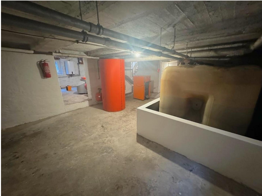
Keller: Öltanks / Holzheizung
