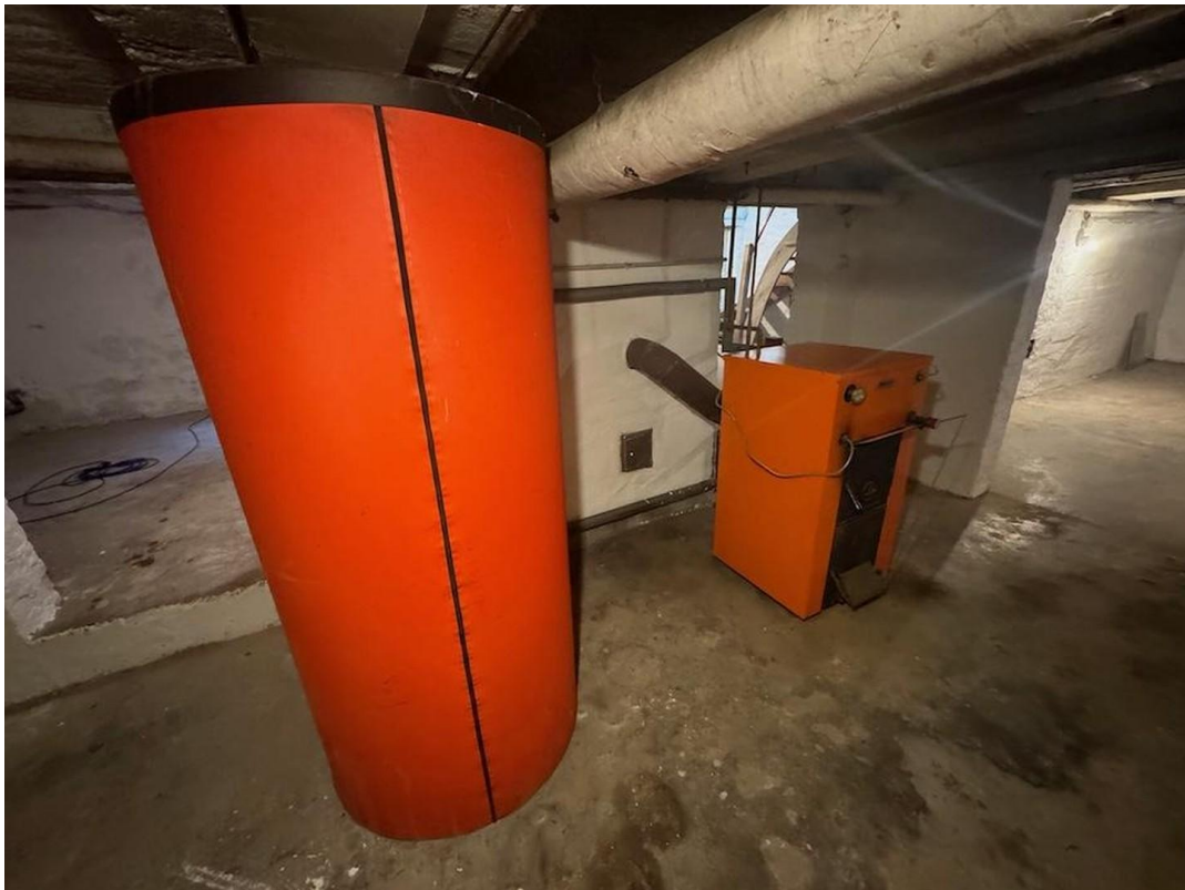
Holzheizung mit Speicher
