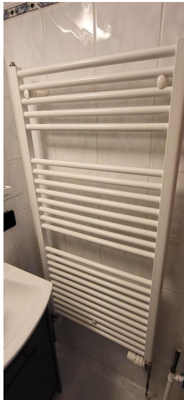
neuer Heizkörper im Bad
