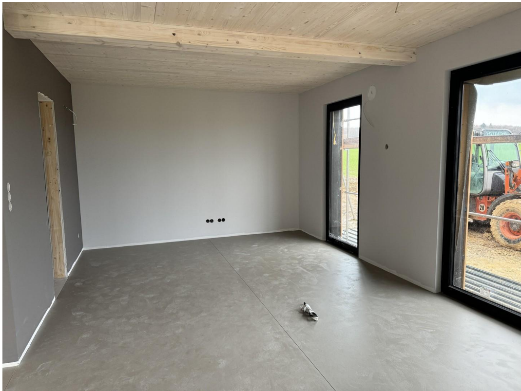
Innentüren fehlen noch
