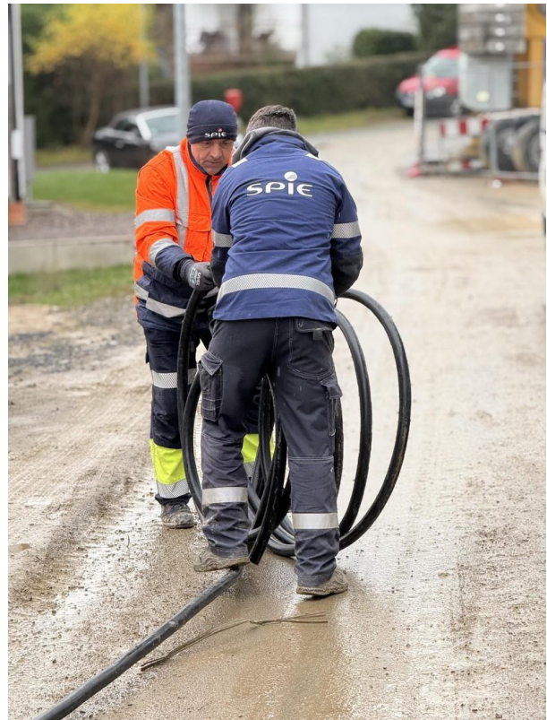
Erschließung Haus D mit Strom
