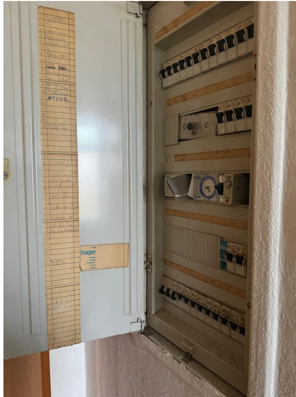
BEISPIEL SICHERUNGSKASTEN 2 OG
