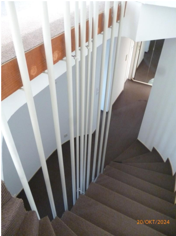
1.OG: Die Stangen sind heizbar
