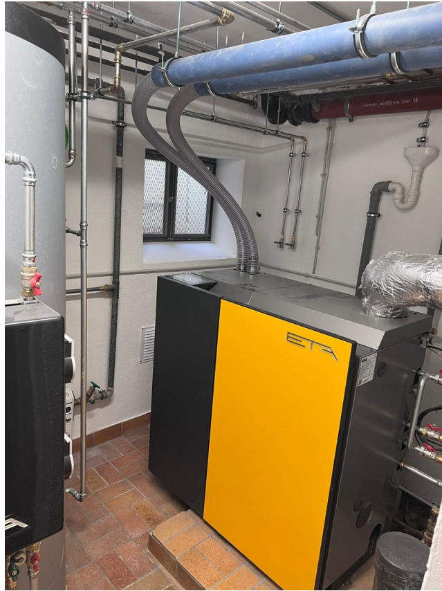
Holzpellet-Heizung im KG
