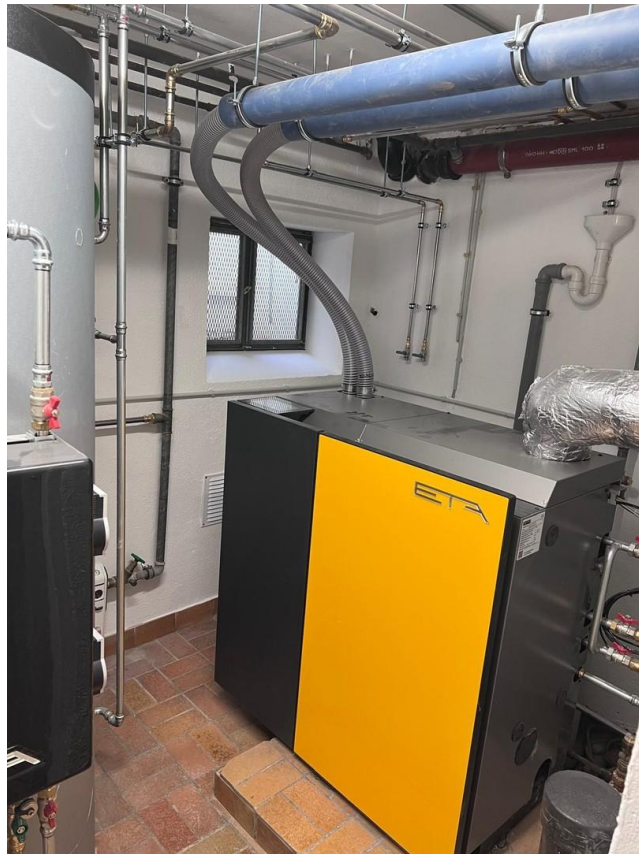
Holzpellet-Heizung im KG
