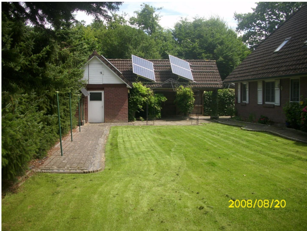
Carport mit Solaranlage
