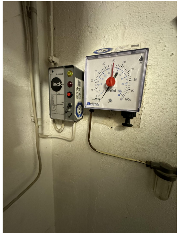
Sicherung Erdtank 10000 Ltr
