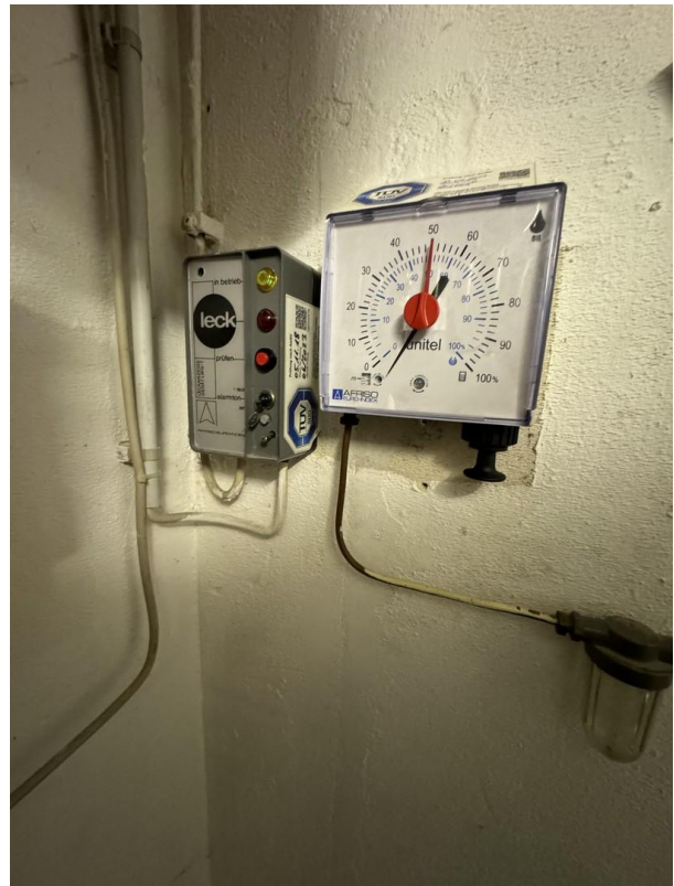
Sicherung Erdtank 10000 Ltr
