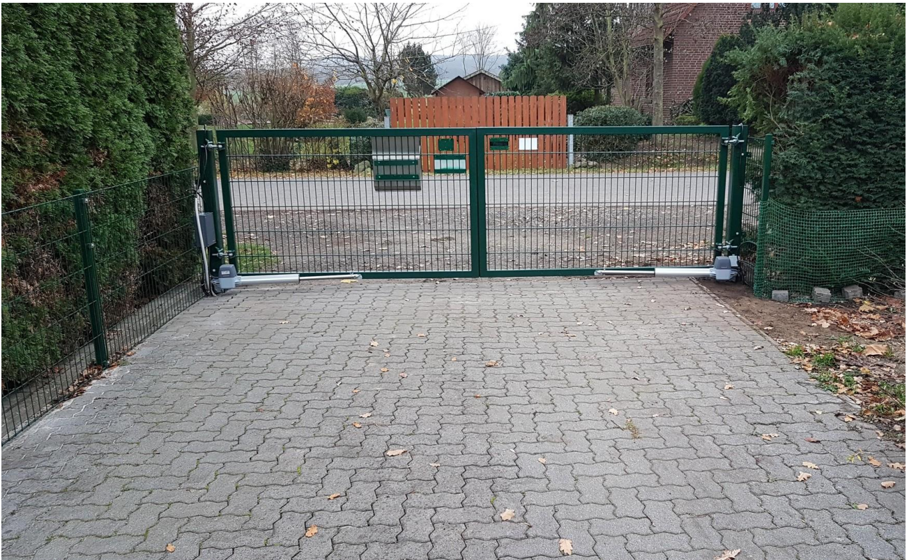
Toreinfahrt /Tor elektr.Antrie
