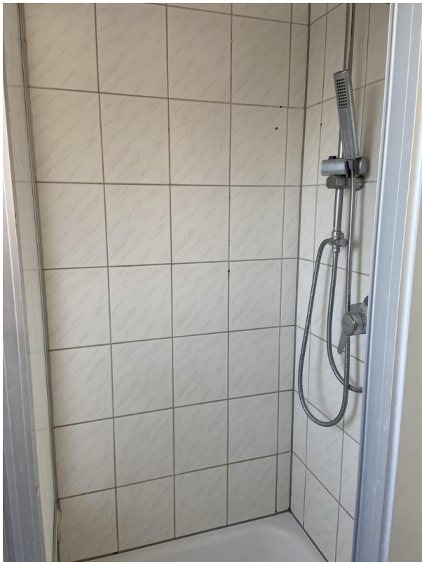
Dusche im Badezimmer
