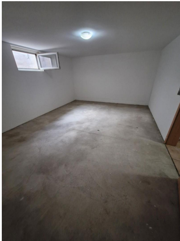
beheizter Kellerraum I
