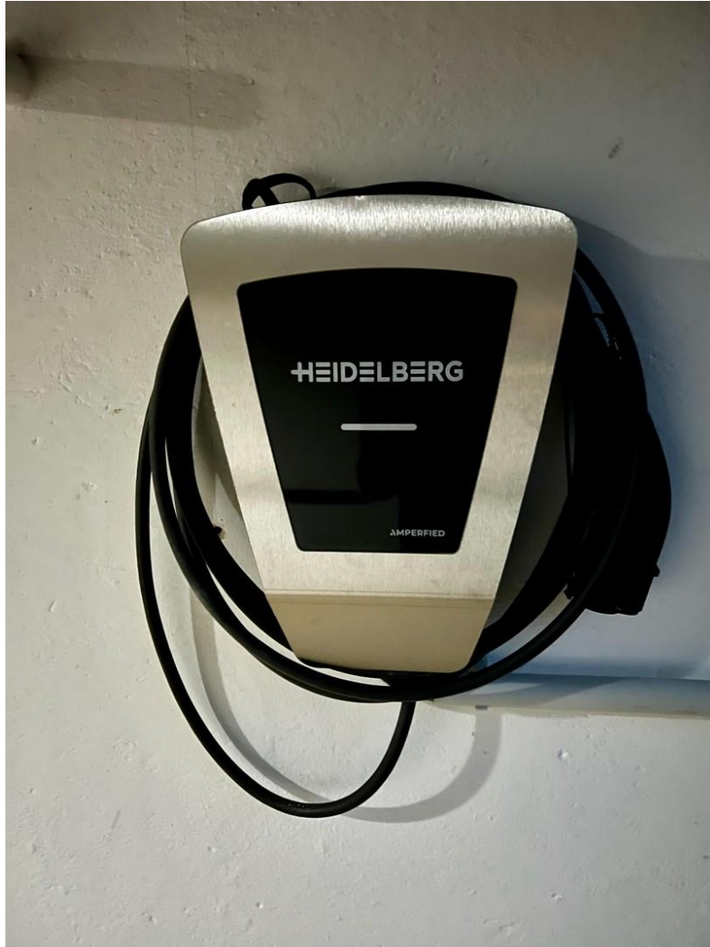
Ladestation in der Garage
