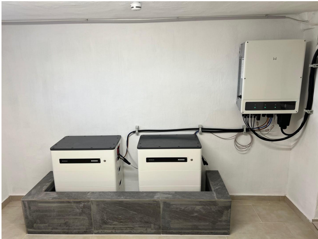
PV Speicher im Keller
