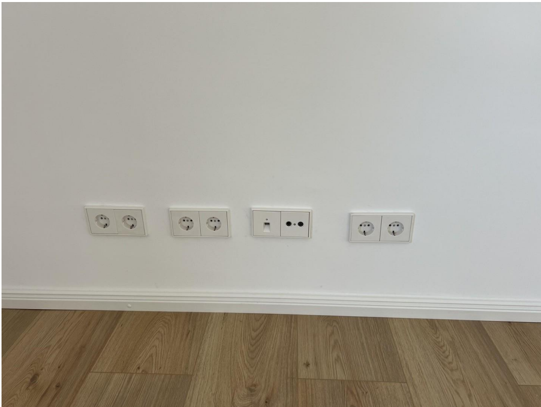
Ethernet und Kabel überall
