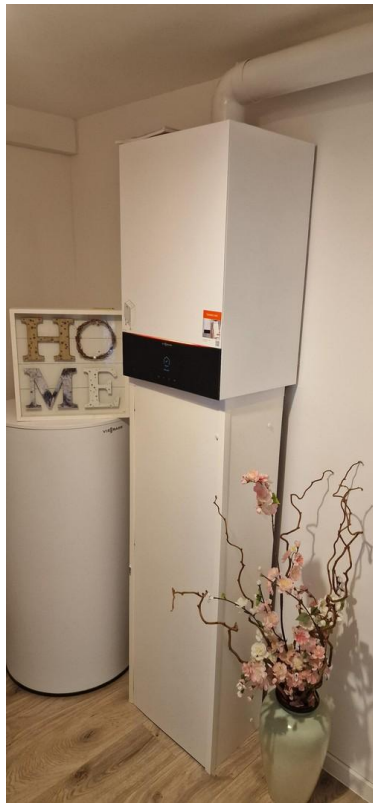
Heizung und Speicher
