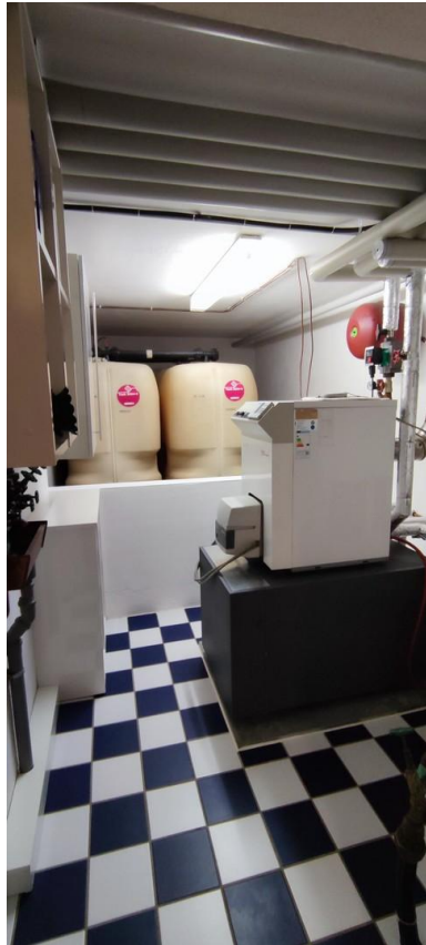
Heiz- und Tankraum
