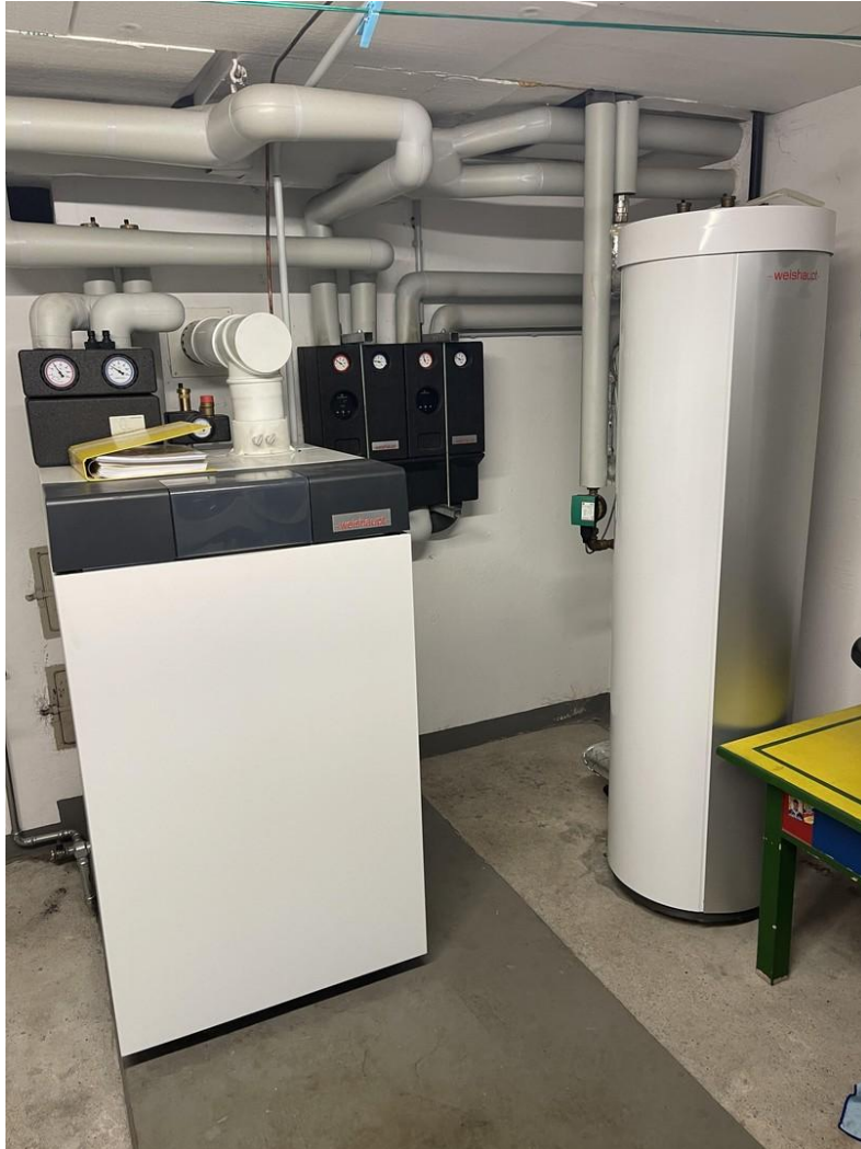
effiziente Öl Brennwertheizung
