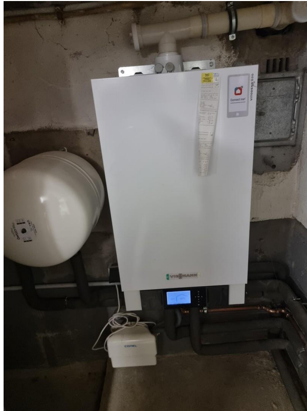
Heizung im Keller
