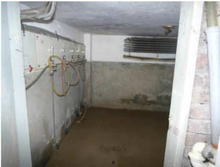
Bild 26 Kellergeschoss Blick in einen Kühlraum mit Zapfanlagen für die Gastronomie.
