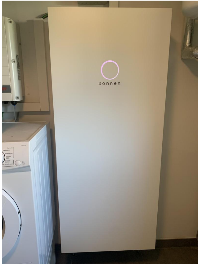
PV-Speicher mit 10kwh
