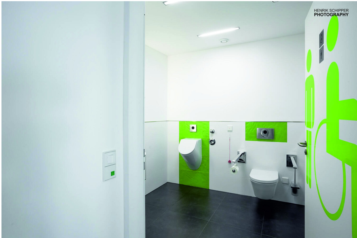
WC Anlage Schulungsraum
