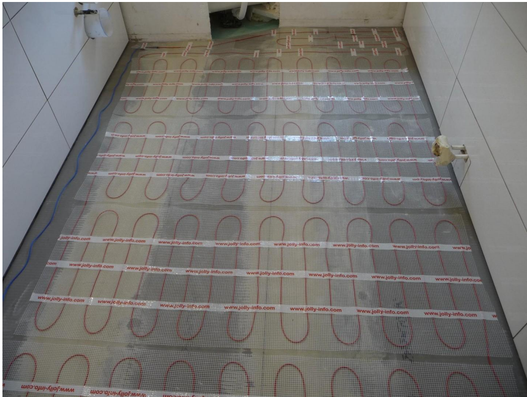
Fußbodenheizung im Bad
