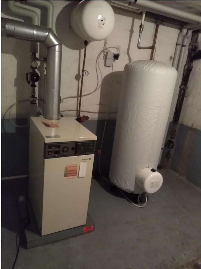
Keller m Heizung
