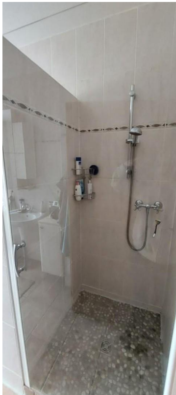
Bad/Dusche untere Wohnung
