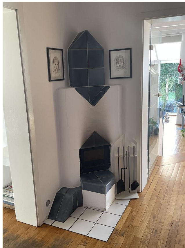
Befuerung Kachelofen im Flur
