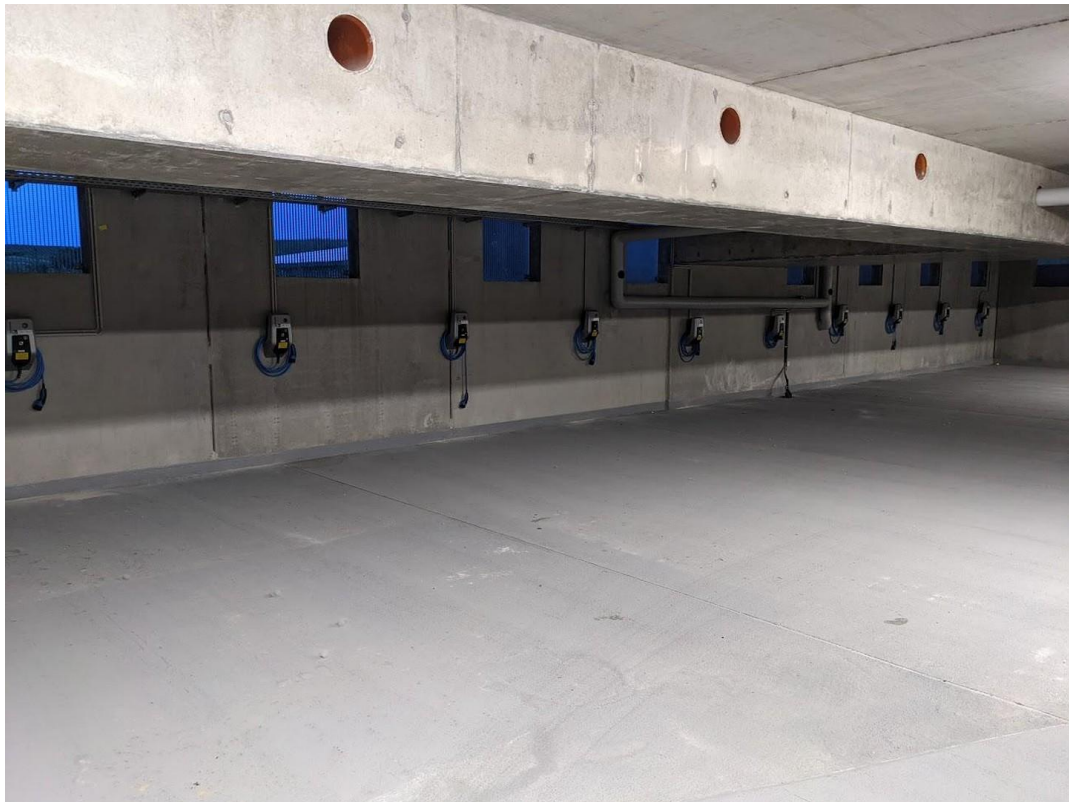
Tiefgarage mit E-Ladestationen
