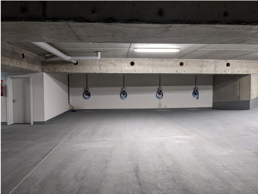
Tiefgarage mit E-Ladestationen
