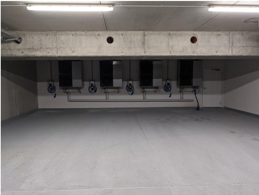
Tiefgarage mit Wärmepumpen
