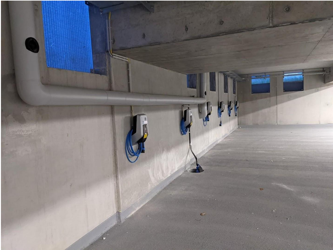
Tiefgarage mit E-Ladestationen
