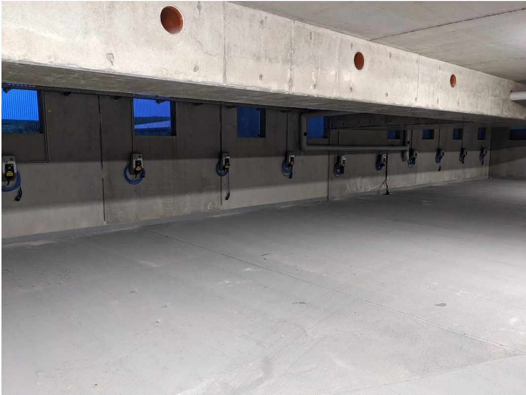
Tiefgarage mit E-Ladestationen
