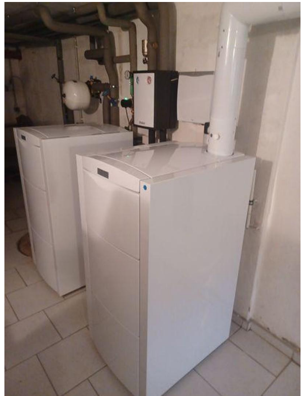
Nagelneue Vaillant Gasheizung
