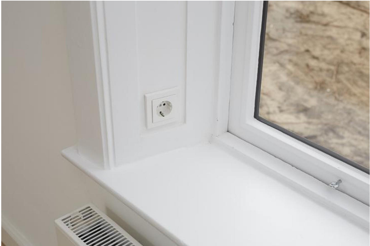
Steckdose in Fensterrahmen
