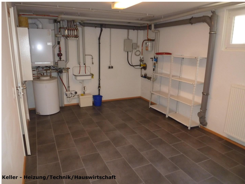
Heizung Technik HWS 1
