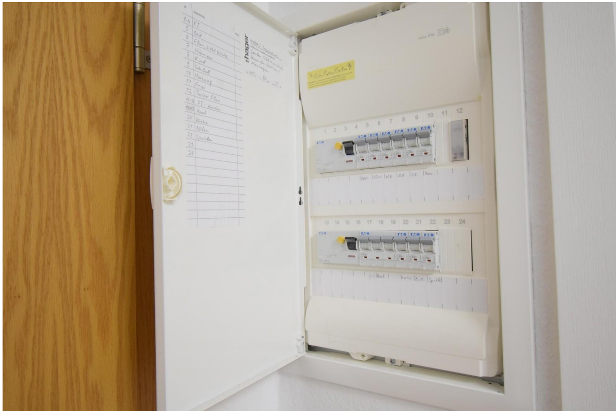
Elektrik mit Unterverteilung
