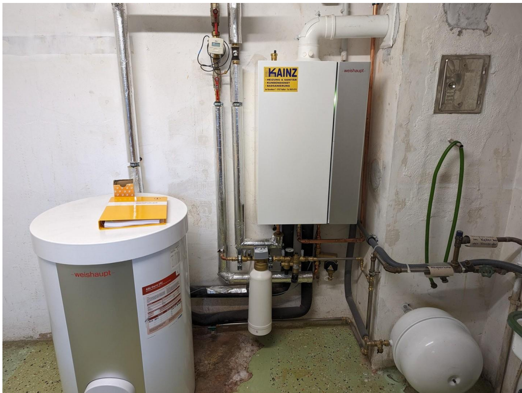
Gasheizung Dez. 2022 EG
