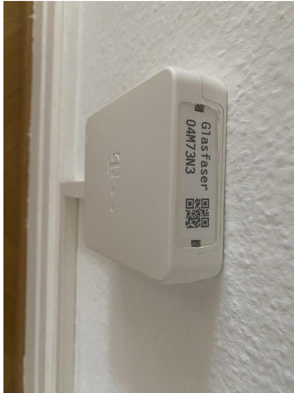
Glasfaser - Fibre optics
