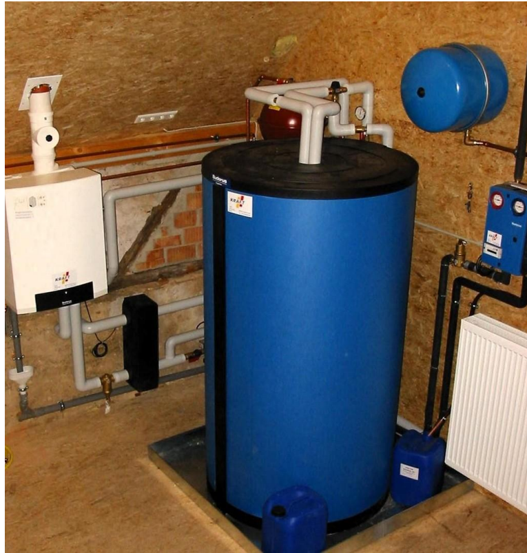
Heizung, Speicher, Solar OG 1
