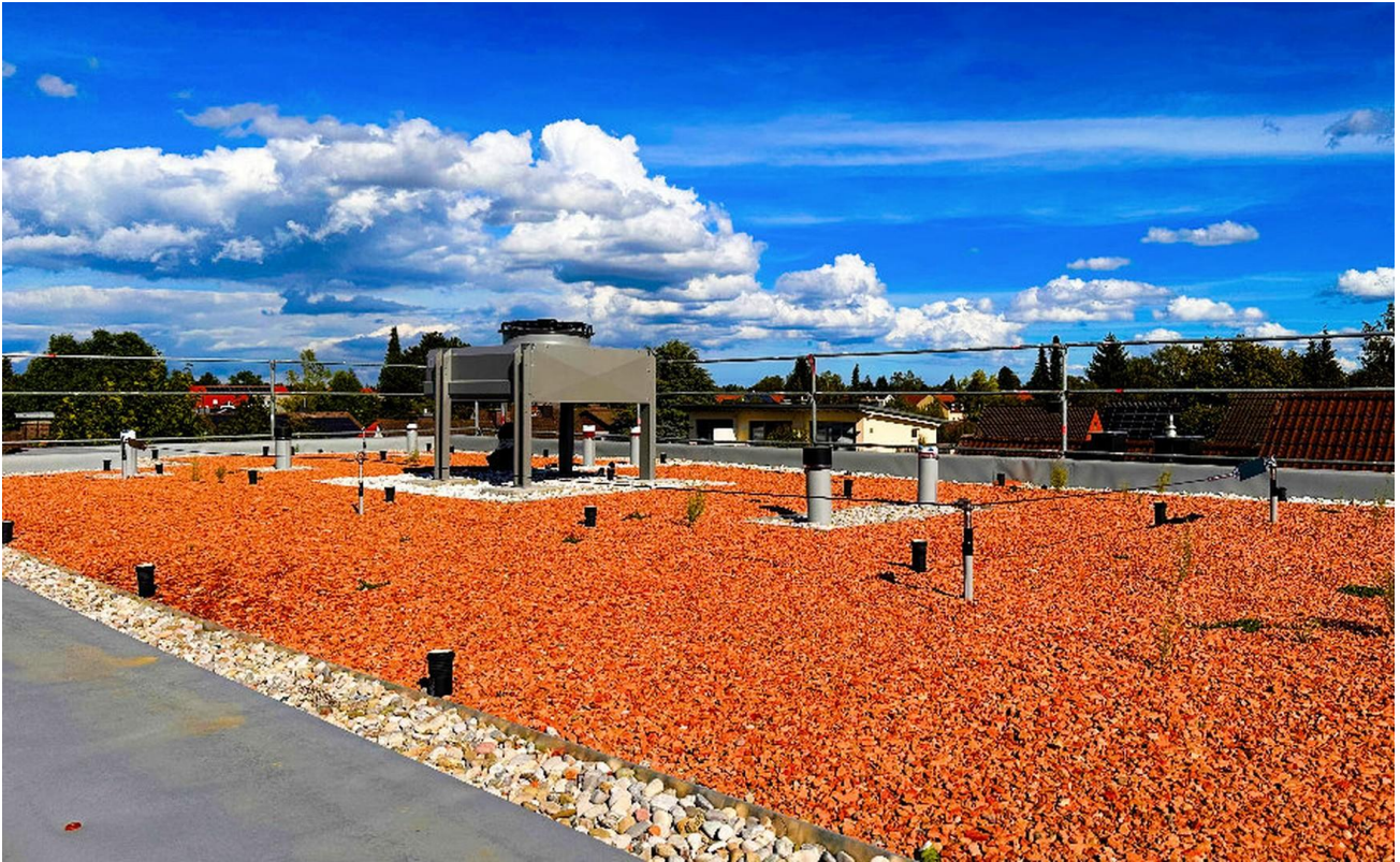
Wärmepumpe auf dem Dach
