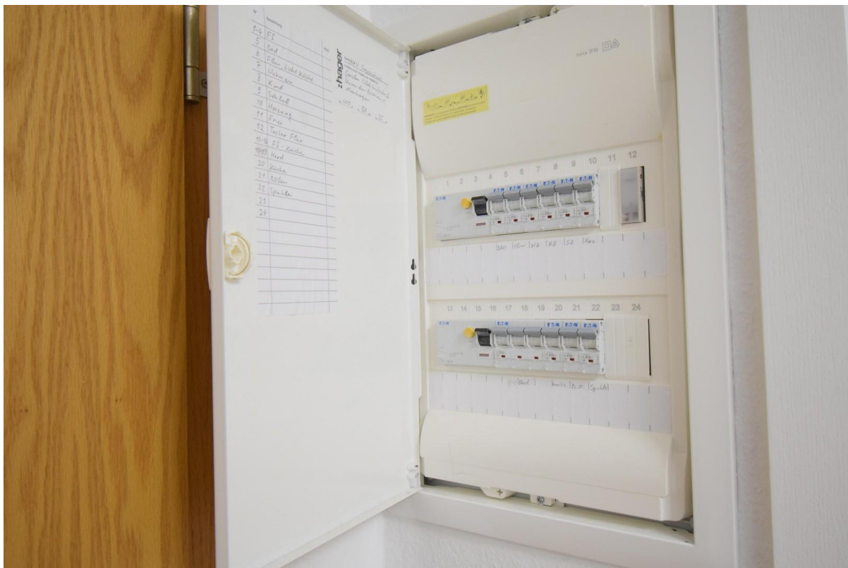
Elektrik mit Unterverteilung
