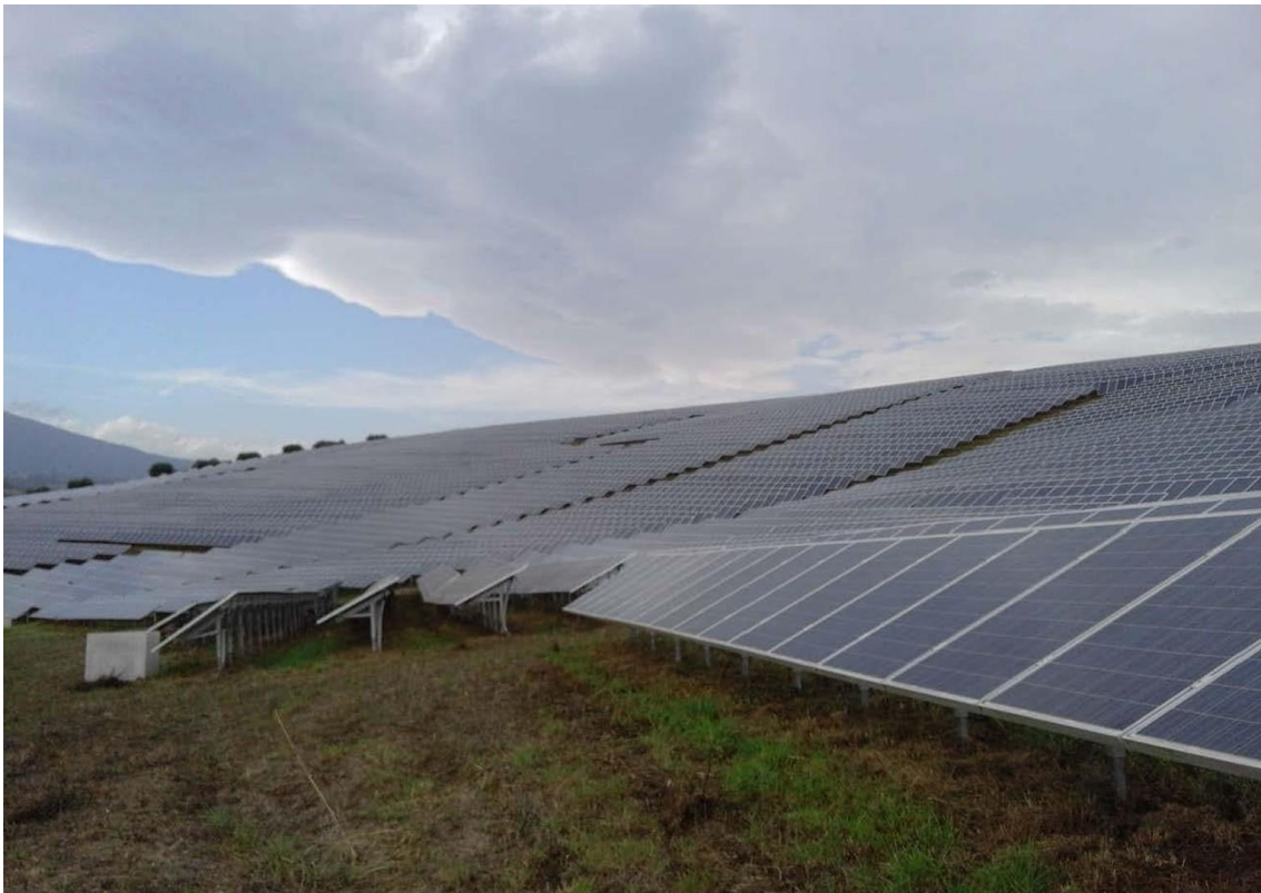
Photovoltaikanlage auf landwir
