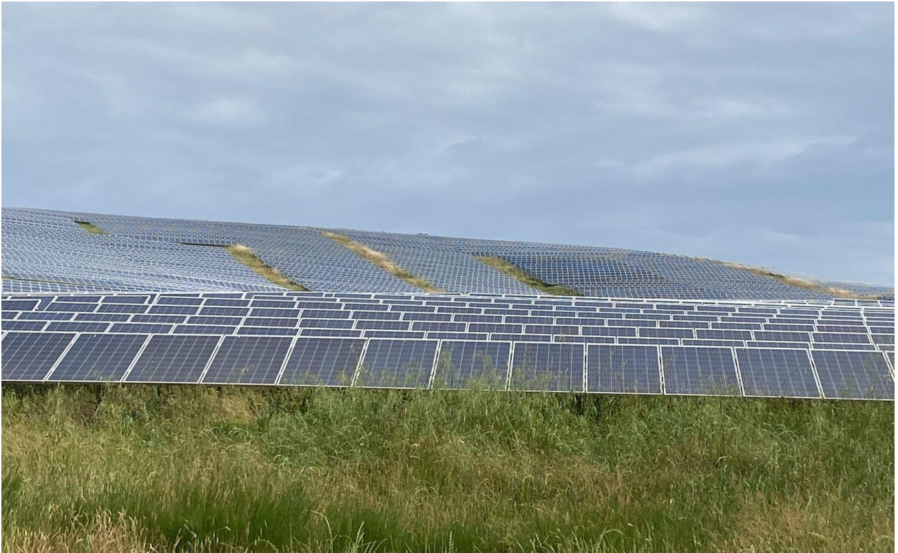
Photovoltaikanlage auf landwir
