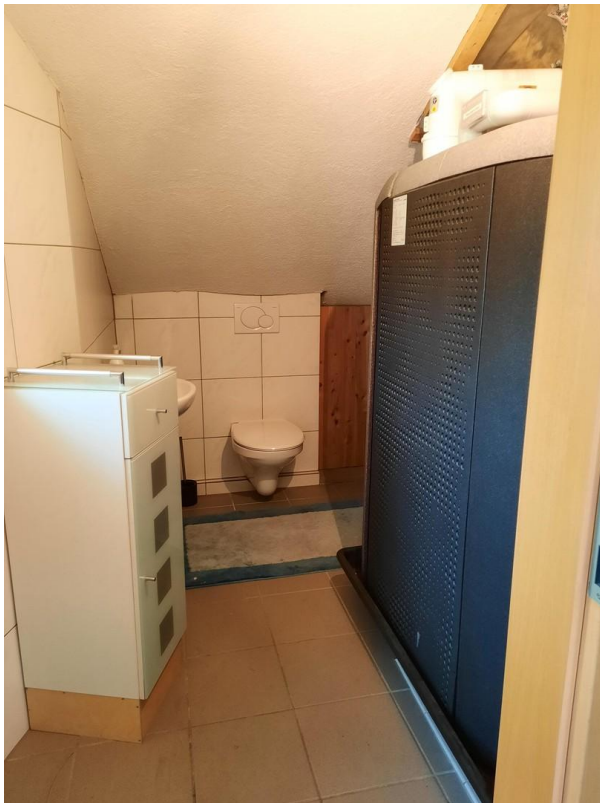
Badezimmer mit Heizung DG
