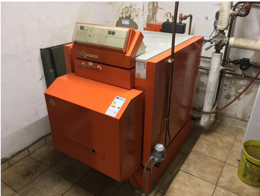
Ölheizung im Keller
