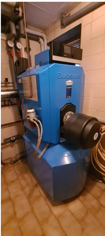
Heizung neu (Waschraum UG)
