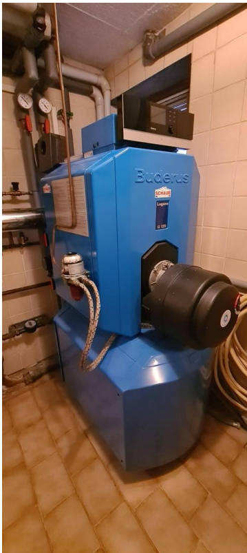
Heizung neu (Waschraum UG)
