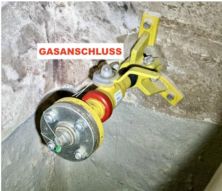
Gasanschluss im Keller
