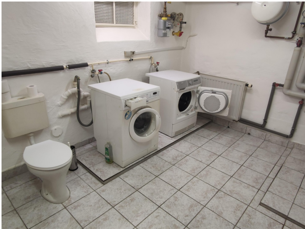
KG Hauswirtschaft mit Heizung
