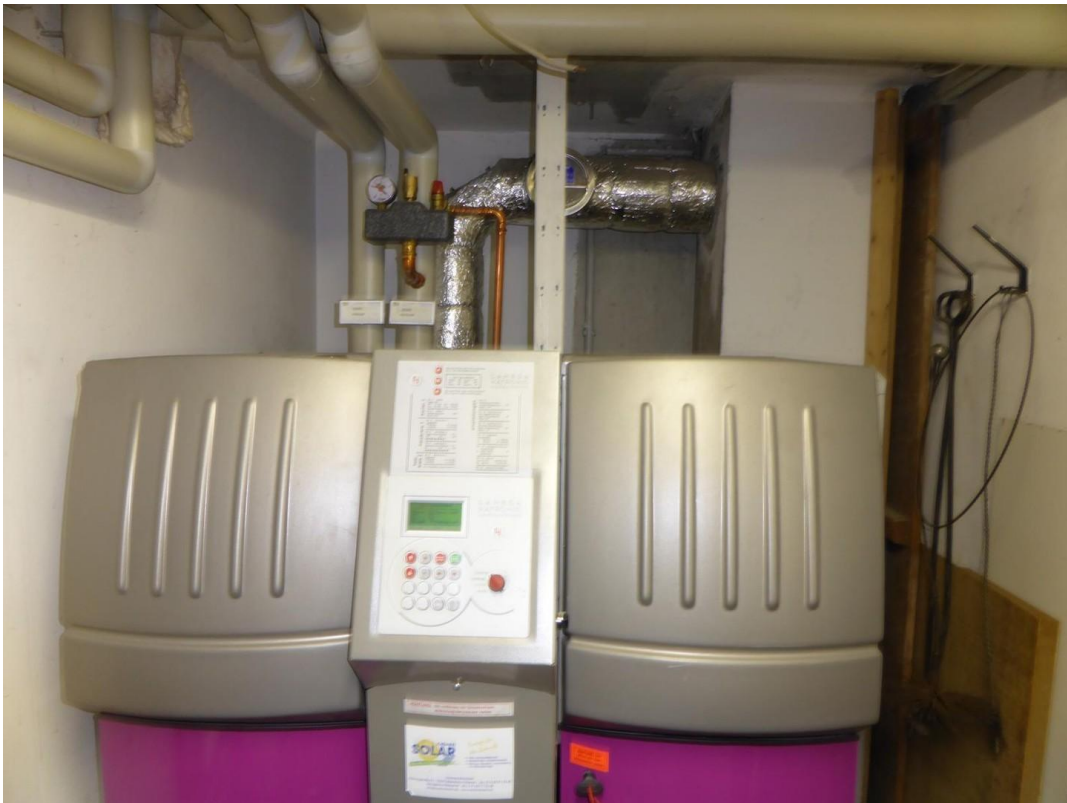
Pelletsheizung im UG
