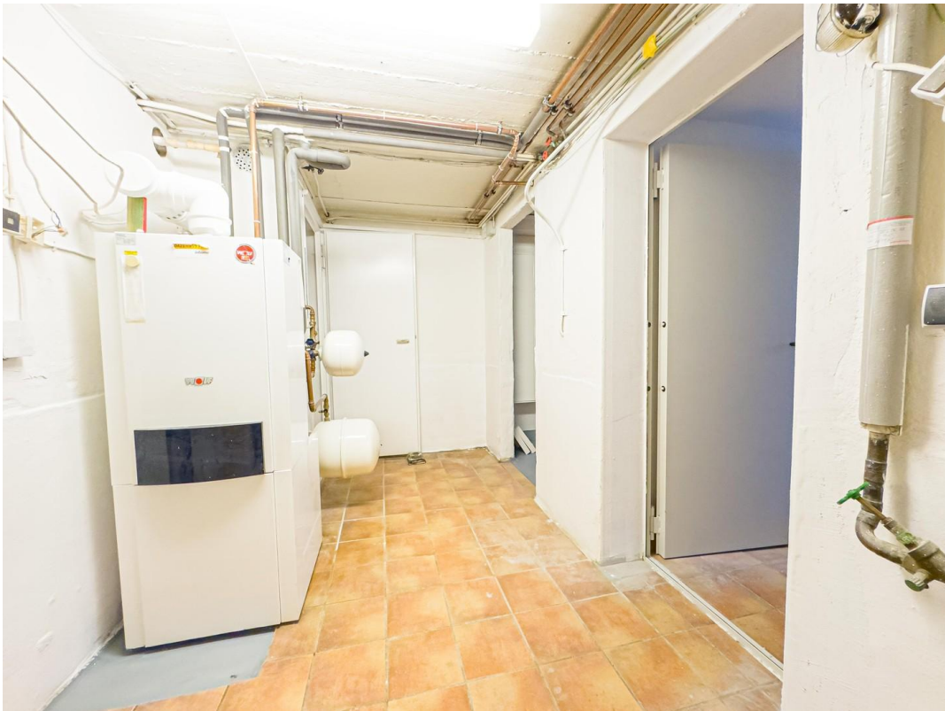
Gasheizung im Keller
