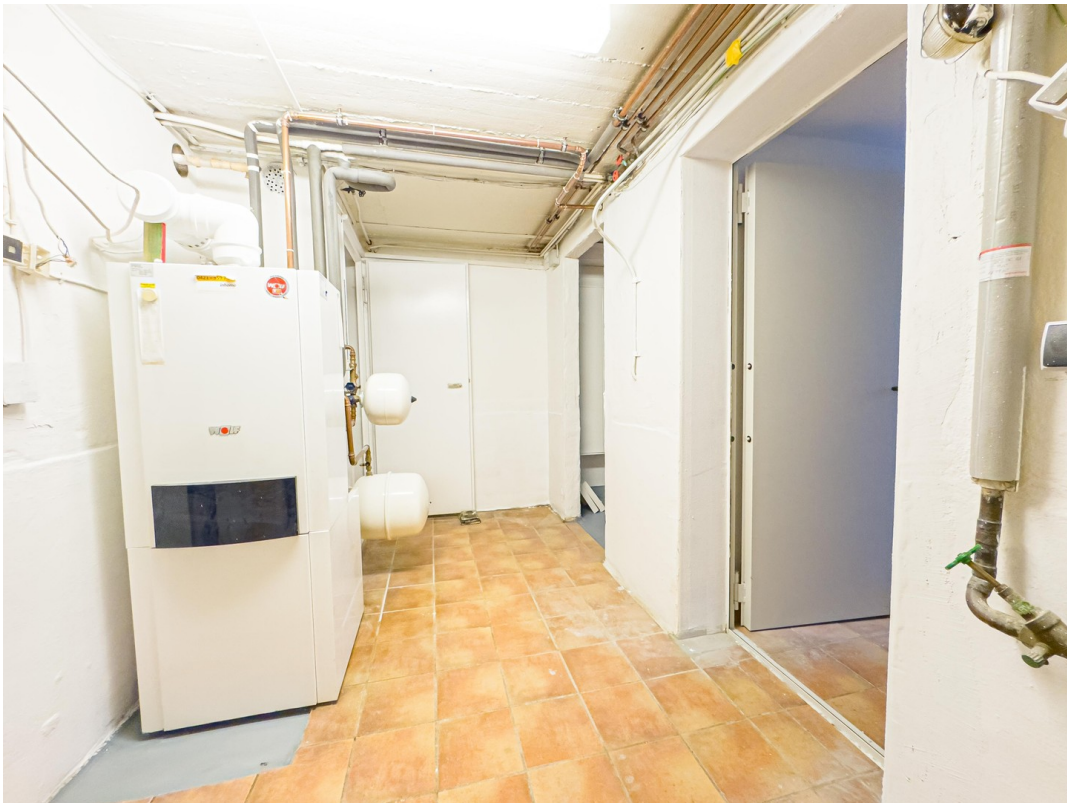
Gasheizung im Keller
