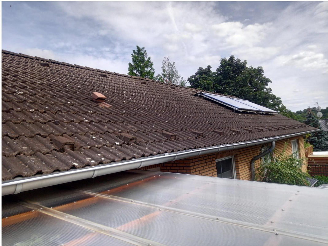
Dach mit Solarthermie
