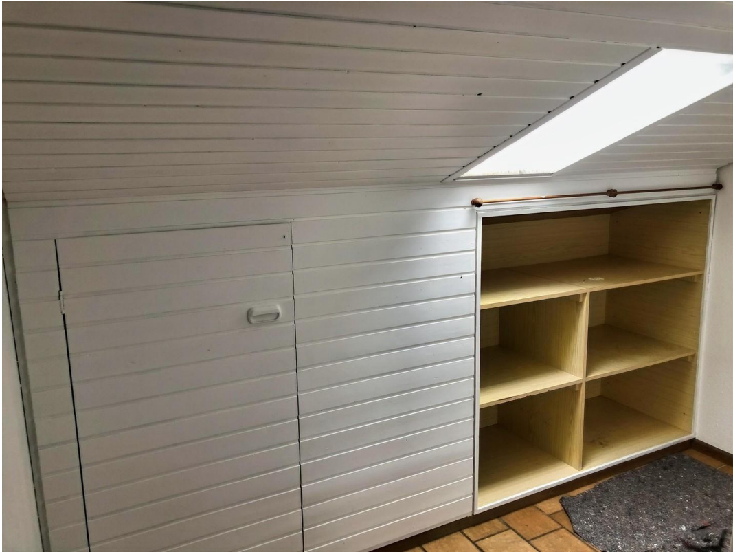
DG Rechts, Speicher
