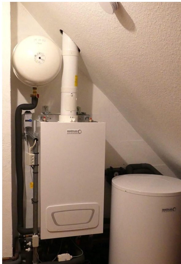
Neue Gastherme mit WW-Speicher
