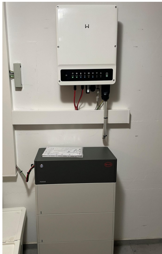
PV-Anlage mit Batteriespeicher
