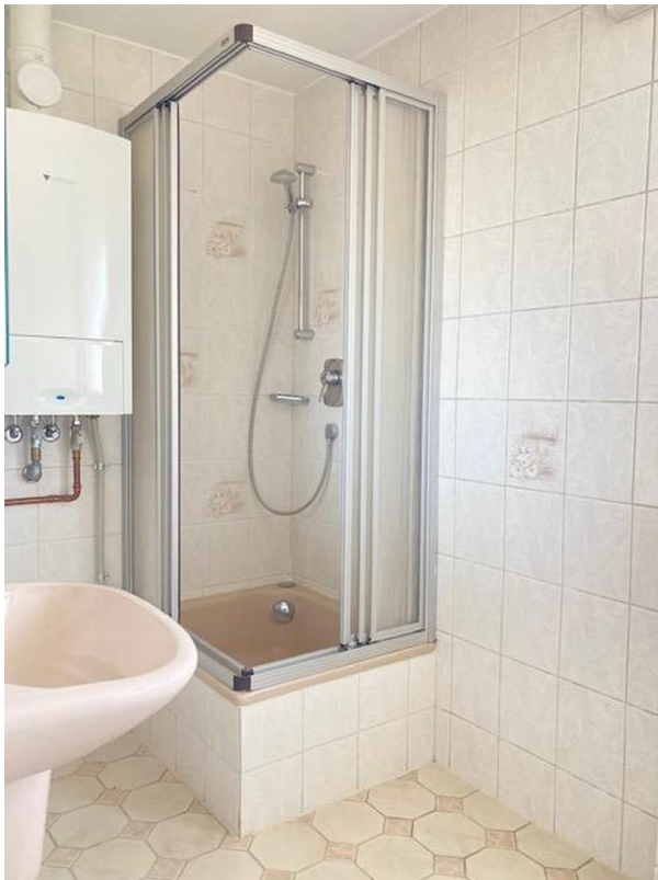
Bad, Dusche, Brennwert-Therme
