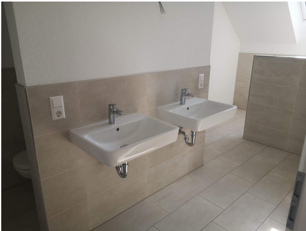
Washbecken T Wand vor Dusche
