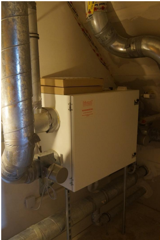
Lüftungsgerät im DG
