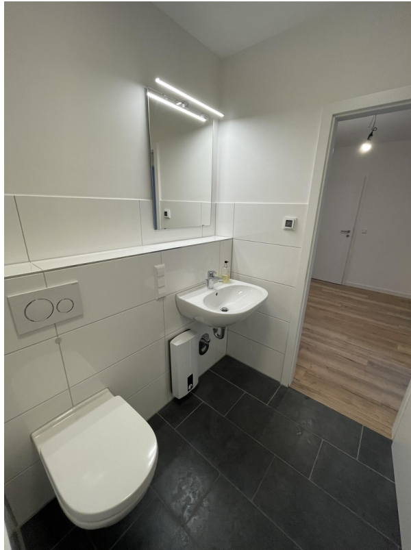
Bad mit Fußbodenheizung
